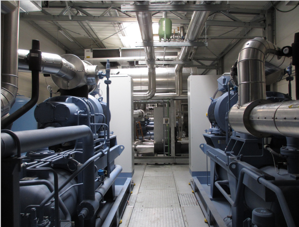
Fig 1: The centralized cooling unit in Høje Taastrup [Høje Taastrup Fjernvarme].
